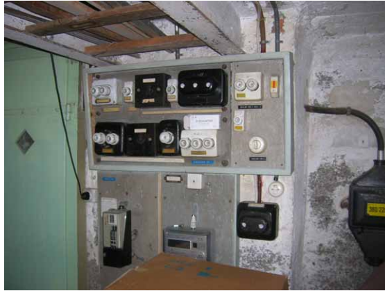
Elektroverteilungen sind häufig mit asbesthaltigem Brandschutz versehen
